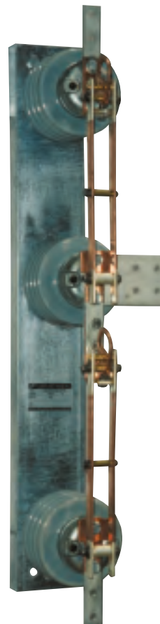
15 kV, 600A. LCO-CT
